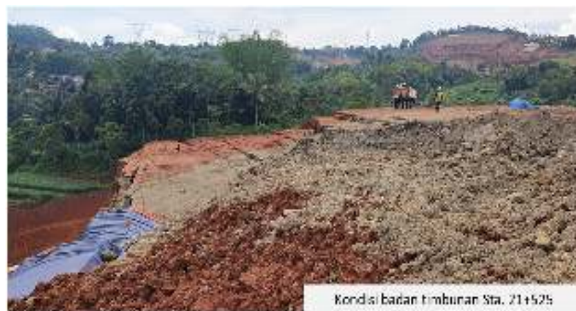
Gambar 5. Kondisi Penurunan di Sta. 21+525
